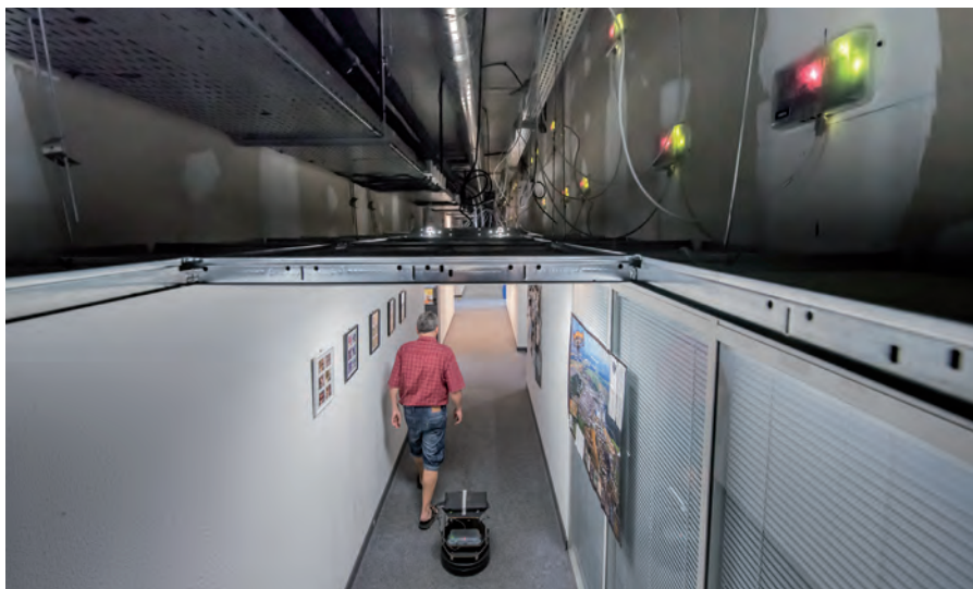
Réseau de capteurs FIT/IoT Lab installés dans le centre Inria Grenoble Rhône-Alpes. © Inria / Photo H. Raguét.
